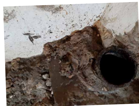
Freigelegtes Abflussrohr nach Verstopfung
