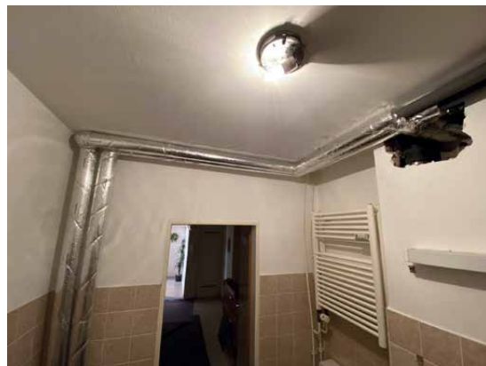
Blick ins Bad / Anschluss Nahwärme
