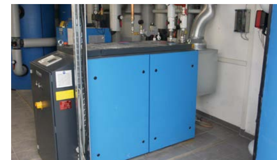
Ein Blockheizkraftwerk sorgt für niedrige Betriebskosten.
